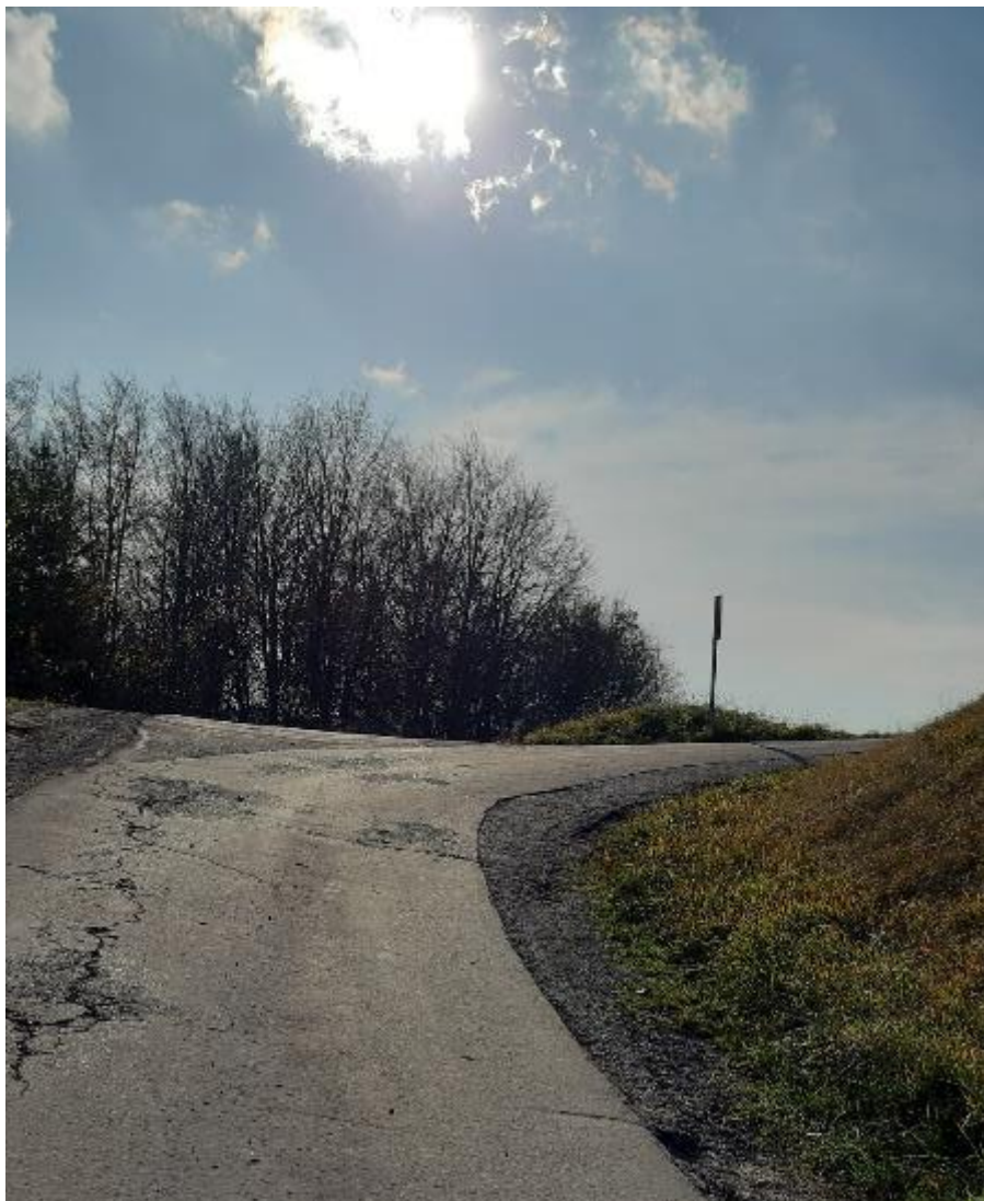
Slika 38: Nevaren odsek št. 13
